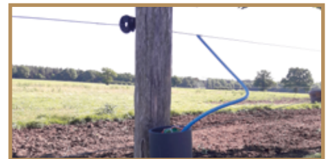
Connexion câble blindé au fil de clôture
