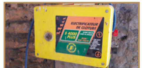
Poste de clôture avec câble haute isolation
