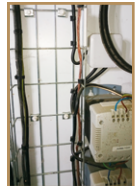
Chemin de câbles mis à la terre
