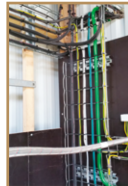
Chemin de câbles bien réalisé
