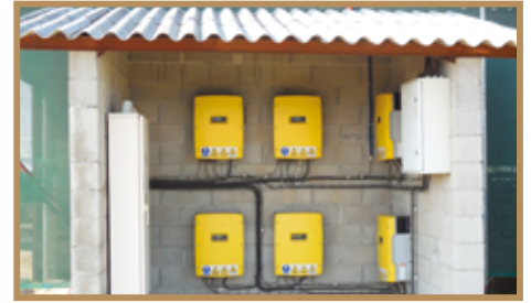
Onduleurs dans local hors du bâtiment
