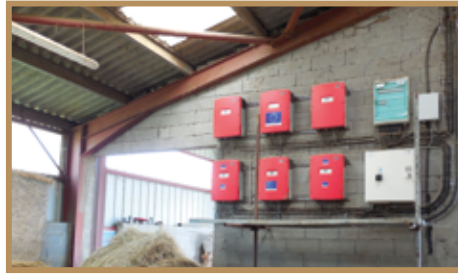
Onduleurs dans bâtiment
