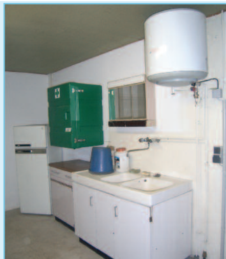
Armoire à pharmacie et réfrigérateur installés dans le local technique, jouxtant les cases d'isolement
